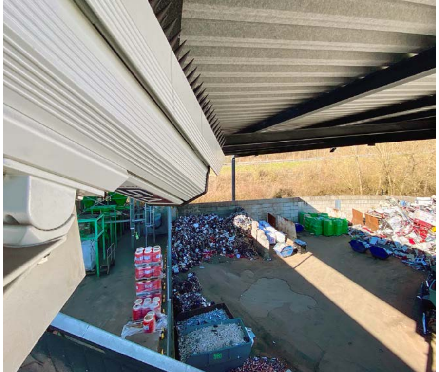
Die Infrarotkamera (links im Bild) erkennt Brände zuverlässig.
